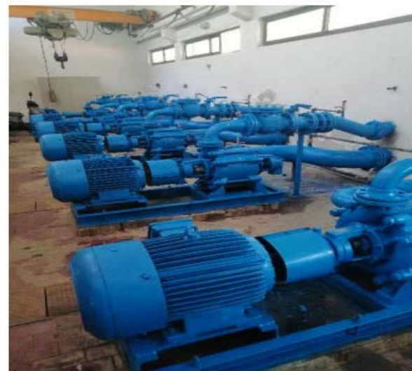
Slika 26: Pumpno postrojenje „Sutomore“
