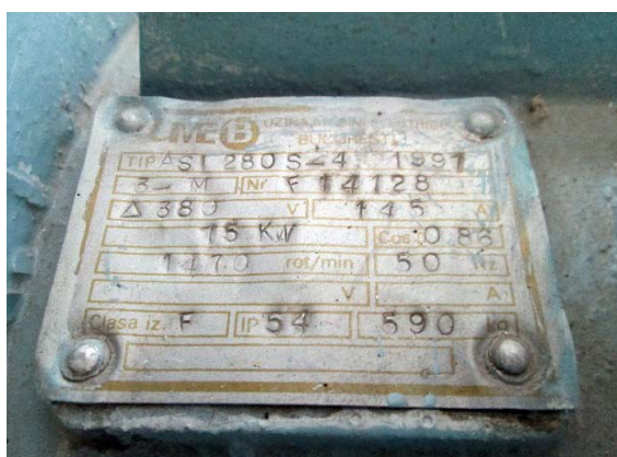
ECHIPAMENTE DE POMPARE ȘI ELECTROMECHANICE TIPICE UTILIZATE ÎN PREZENT ÎN ROMÂNIA/CREDIT AQUASERV TÂRGU MUREȘ
