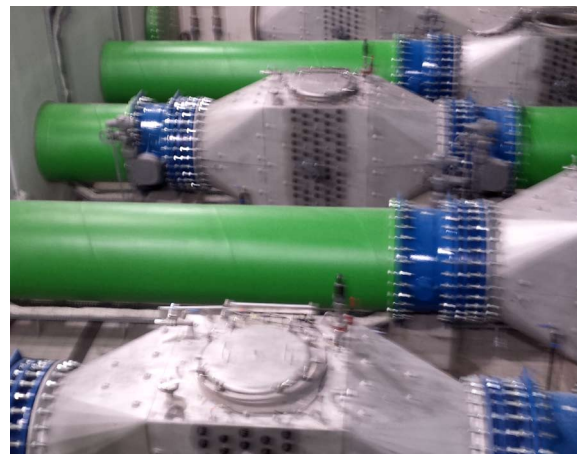
COMPANIE DE UTILITĂȚI DIN BELGRAD, STAȚIE DE APĂ POTABILĂ
