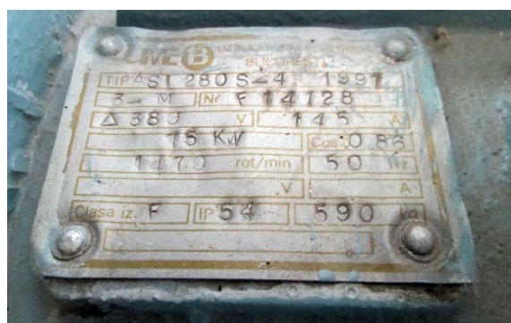
ТИПИЧНО ЗА РУМЪНИЯ ПОМПЕНО И ЕЛЕКТРОМЕХАНИЧНО ОБОРУДВАНЕ / CREDIT AQUASERV, ТЪРГУ МУРЕШ
