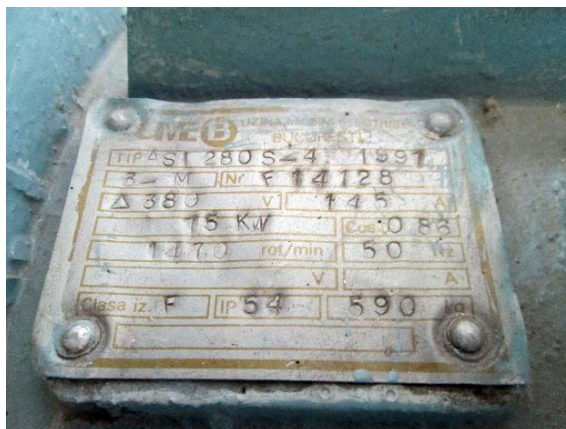
TIPIČNA POSTOJEĆA PUMPNA I ELEKTROMEHANIČKA OPREMA U RUMUNJI / KREDIT AQUASERV TARGU MURES
